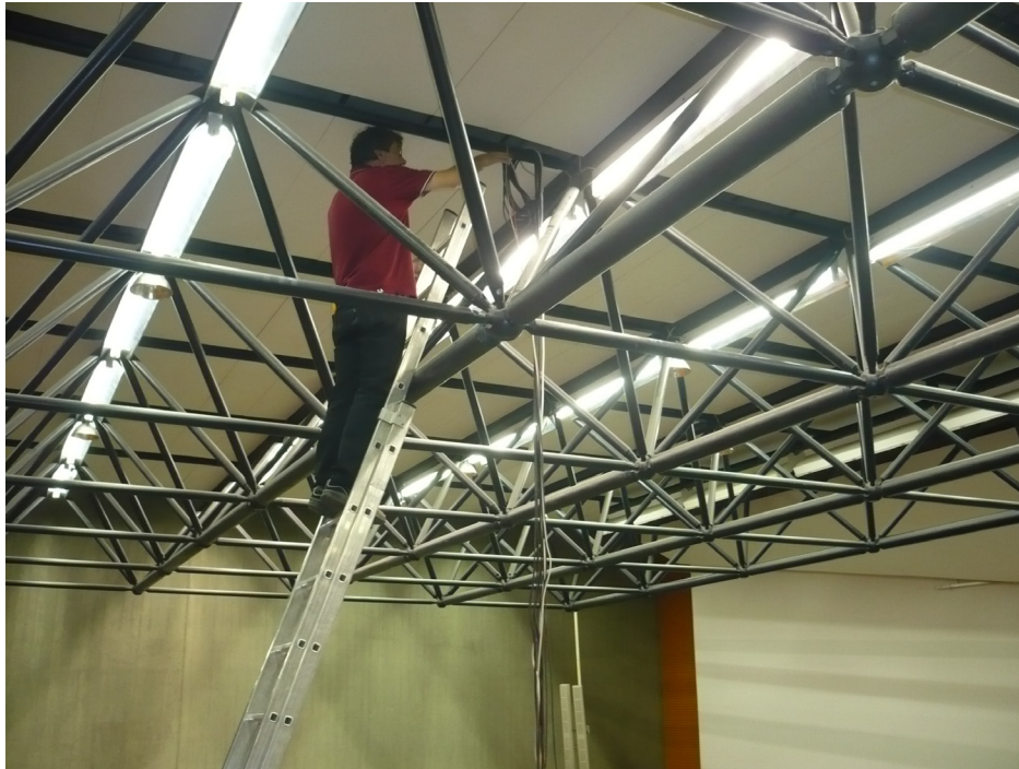
Abbildung 19: Beamerinstallation in einem Hörsaal der Chemie
