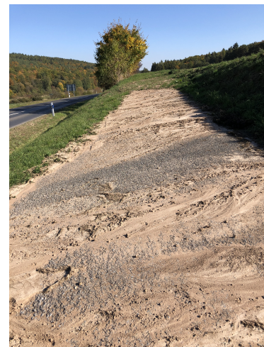
(c) Off-site -Schaden: Verschmutzung einer Straße
