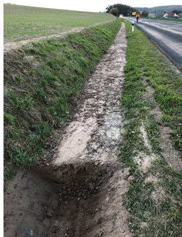
(b) Off-site -Schaden: Verstopfung einer Ablaufrinne
