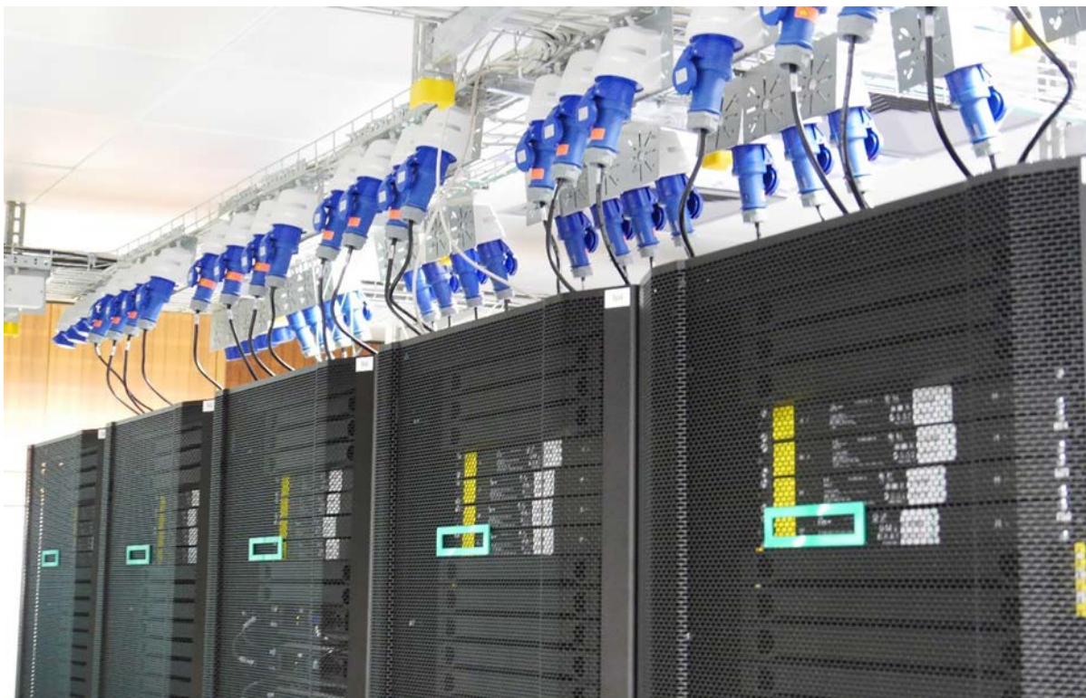
Abbildung 3: Der im Maschinenraum 1 installierte HPC-Cluster
