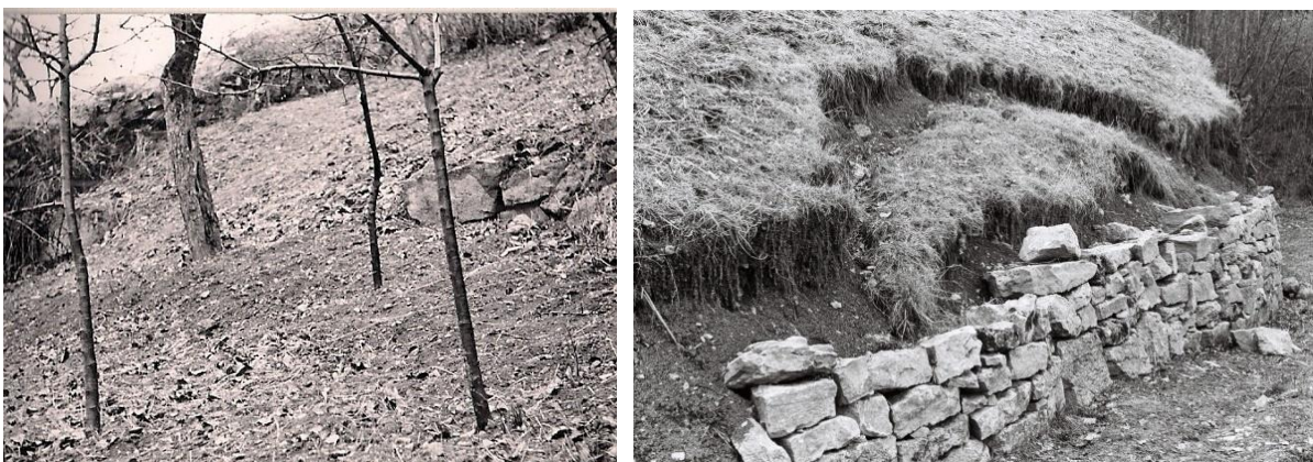
Abb. 32 Links: Hangabwärts erfolgte Überschüttung einer der wenigen Quermauern am Rebhang bei Haagen im Vorbachtal. Die Bäume sind vom herabtransportierten Material eingeschüttet. Rechts: Rutschung infolge Unterschneidung bei Wegebau am Hang. Beide Fotos März 1959.
