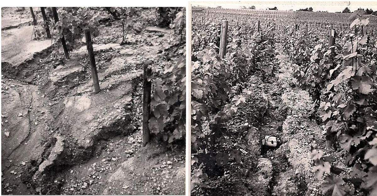
Abb. 40 Nach Starkregen am 19. Juni 1957 vor Beginn der Flurbereinigung entstandene Gräben an 15° steilem Rebhang bei Randersacker am Main. Die am Oberhang ca. 10 cm eingeschnittenen Gräben führten am Unterhang zu Sedimentationsdecken, in die sich sekundäre Gräben eingetieft haben. Heute ist Grabenreißen an Rebhängen seltener, weil die Flächen zwischen den Rebzeilen begrünt sind und Oberflächenwasser auf betonierten, gegen den Hang leicht schräg gestellten Querwegen gesammelt und abgeleitet wird.
