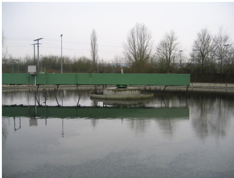
Abbildung 8: Nachklärbecken einer kommunalen Kläranlage zur Abtrennung des Belebtschlammes vom gereinigten Wasser. Durch Herabsetzen der Fließgeschwindigkeit sedimentiert der Belebtschlamm zum Beckenboden. Das verbleibende, gereinigte Wasser wird in den Vorfluter geleitet. (Foto: Knaf)
