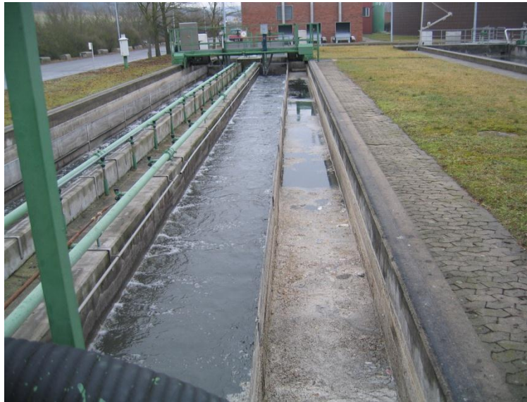
Abbildung 3: Belüfteter Sandfang einer kommunalen Kläranlage mit integriertem Fettfang (rechts). Durch Erzeugung einer kreisförmigen Strömungsbewegung im Sandfang flotiert das Fett im nicht belüfteten Fettfang und kann dort an der Wasseroberfläche abgezogen werden. (Foto: Knaf)
