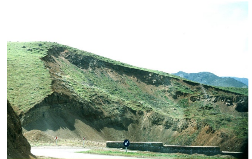
Abb. 123: ▲ Photo i16-02-14, Lage zwischen den GPS-Punkten AL10 und QA96: Abrutschung eines destabilisierten Straßenanschnittes in einer Kehre
