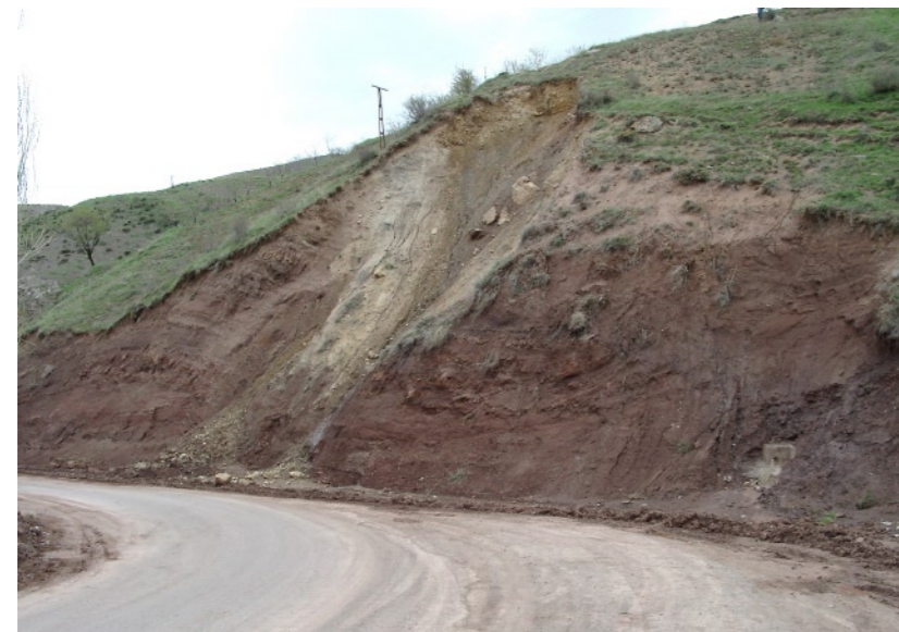
Abb. 68: ▼ Photo 04250025: Abrissnische, entstanden durch Straßenanschnitt, mit nachrutschendem Material als Folgeerscheinung. Diese Abrissnischen treten im Testgebiet häufig auf den wenig konsolidierten Materialverbänden großer Rutschungsmassen auf.
