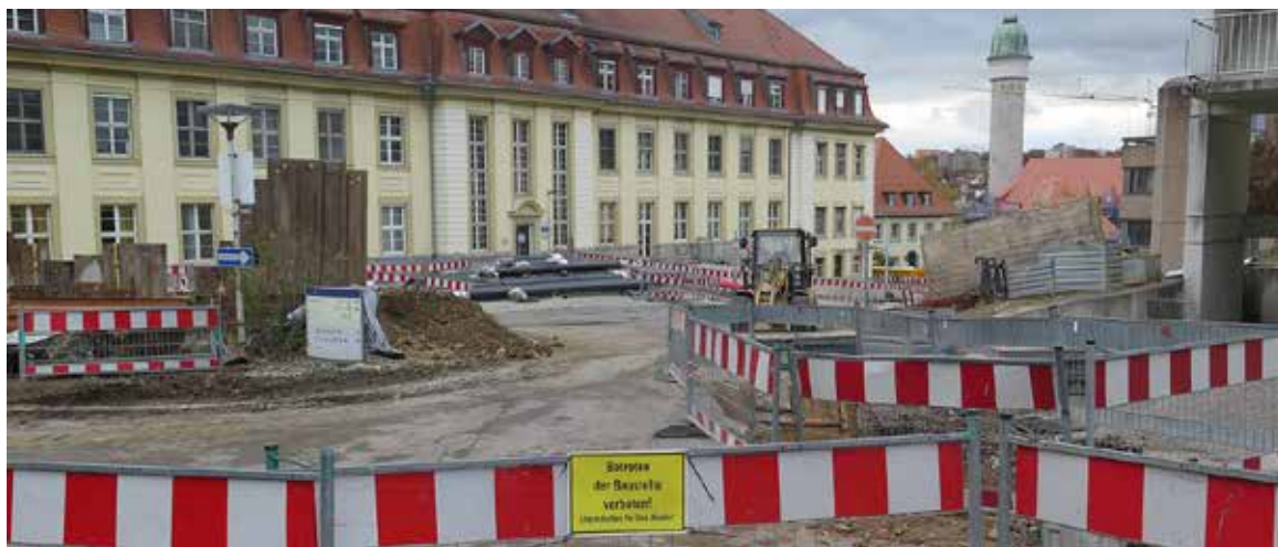
Das Netz der unterirdischen Versorgungsleitungen auf dem Altcampus des Uniklinikums wird in mehreren Bauabschnitten erneuert. (Foto: Rita Börste / UKW)
