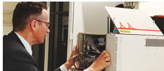
Matthias Funken, Leiter des Rechenzentrums, am damals zentralen Netzwerk-Knoten „WROUo1“ (Foto: Rechenzentrum / Universität Würzburg)
