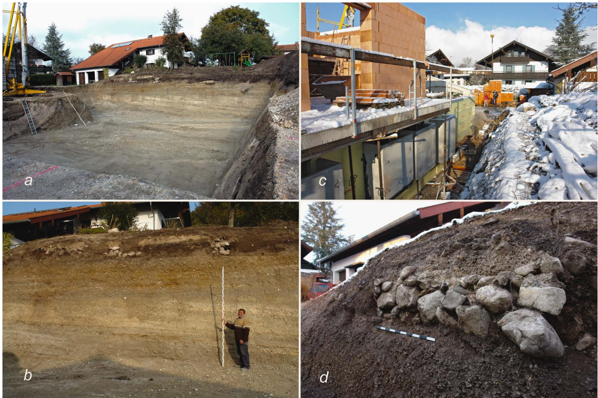
Abb. 4. Zustand bei Dokumentation und Bergung. a: Situation vor Beginn der Dokumentation. b: Detail mit Fundamentresten vor Beginn der Dokumentation. c: Situation während des Putzens des Profils. d: geputzter Profilausschnitt mit Fundamentbefund, Boden nach Nachtfrost aufgetaut (Fotos : S. Möslein).
