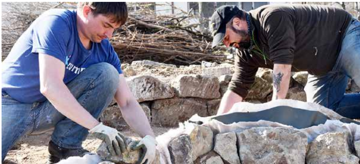
Bis der neue CampusGarten in voller Pracht steht, ist noch viel Arbeit nötig. Hier bauen Simon Moser und Pascal Bunk gerade am neuen Teich. (Bild: Pressestelle Uni Würzburg)
