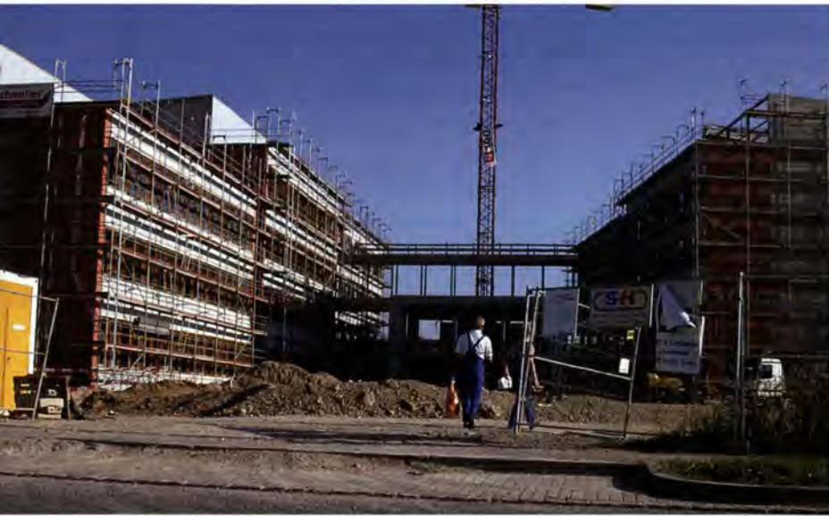
Abb. 14: Gebäude des neuen Science Parks, der im Rahmen der High-Tech-Offensive Bayern errichtet wird. Quelle: BioMedTec Franken e.V.
