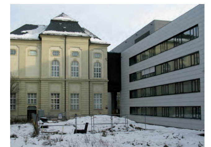
Der neue Gebäudeteil der Teilbibliothek Wittelsbacherplatz und die Arbeiten während der Abbruchphase
