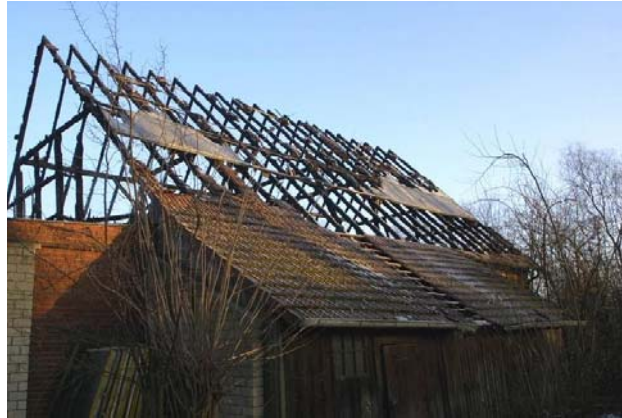
Figure 8: Fire damage of a PV installation (photo: ©GESAMTVERBAND DER DEUTSCHEN VERSICHERUNGSWIRTSCHAFT)
