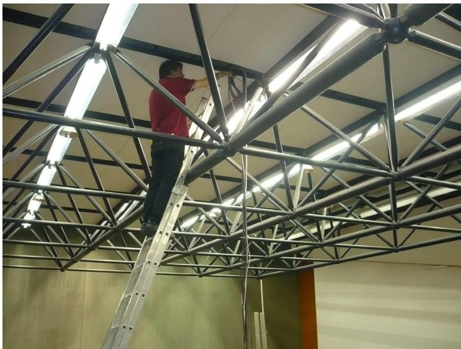
Abbildung 17: Beamerinstallation in einem Hörsaal der Chemie
